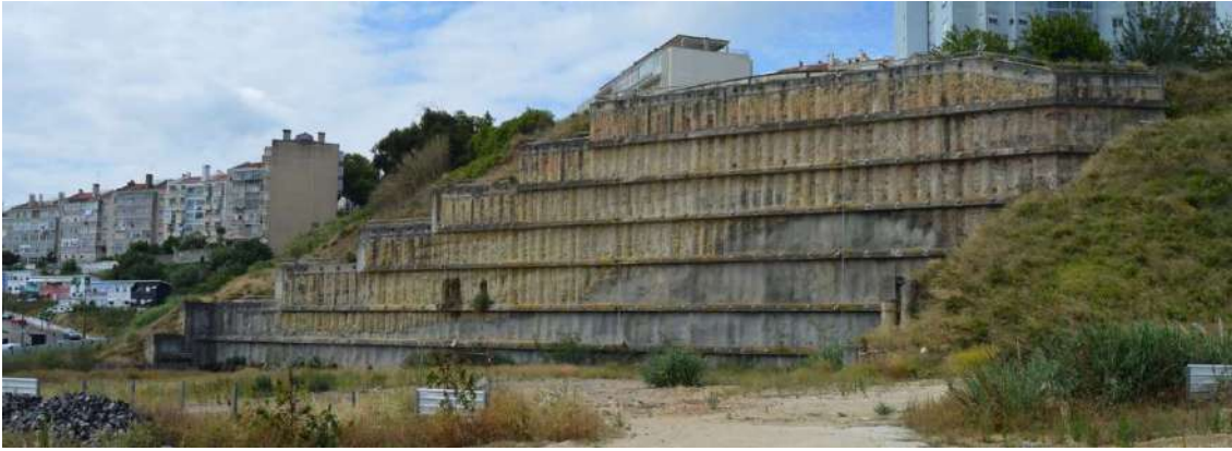
Figura 17 – Escavação profunda com solução de contenção dentro dos limites da área do Plano
