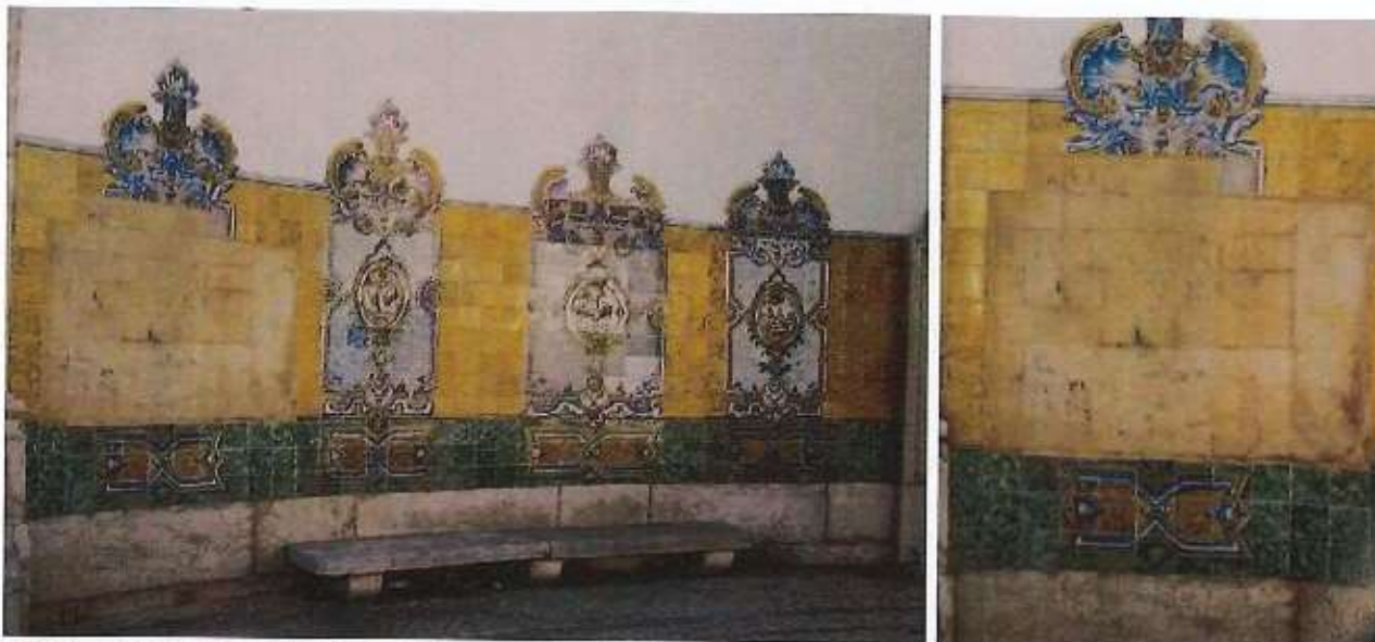
Fig. 18 – Fotos enviadas pela JFA em 2011, mostrando o furto de um silhar quase completo do Chafariz da Junqueira.
